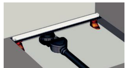
Sprchový kanálek připojte k odpadu, na kanálek položte polystyren jako ochranu pro následnou instalaci.
